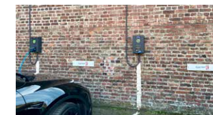
Nos parkings, siège et usine, sont équipés de borne de recharge pour véhicule électrique
