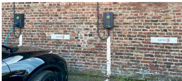
Nos parkings, siège et usine, sont équipés de borne de recharge pour véhicule électrique
